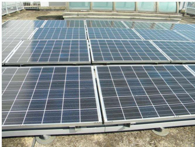
建物屋上に設置された太陽光パネル
