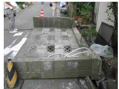
(ブロック塀の倒壊の事例)
