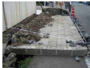
(ブロック塀の倒壊の事例)
