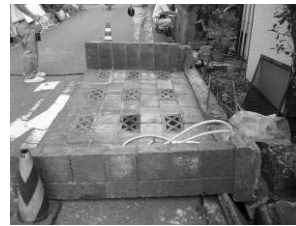
(ブロック塀の倒壊の事例)
