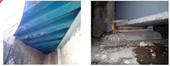
鋼部材の腐食
