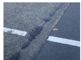
伸縮装置の劣化
