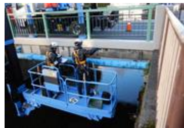
早期発見・ 早期修繕が重要
