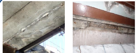
コンクリート部材の遊離石灰
