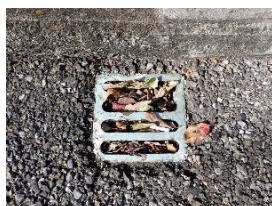
排水口の土砂詰まり
