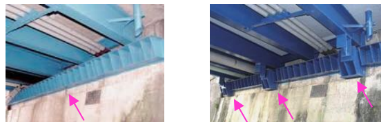
整備前 旧基準による落橋防止システム 整備後 平成15年度整備 / 神明橋(昭和43年架設 善福寺川)
