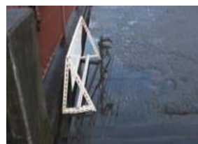
排水設備機能不全で滞水
