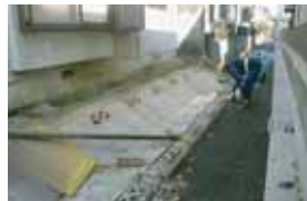
○災害時の避難路として危険 (東日本大震災時に塀が倒れ、道を塞いだ例)
