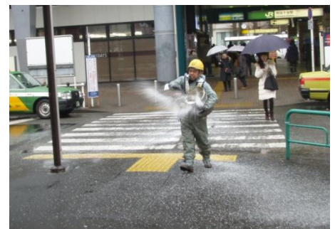
路面凍結防止対策
