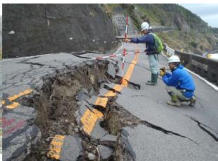
被災状況の測量調査 (出典：国土交通省資料)
