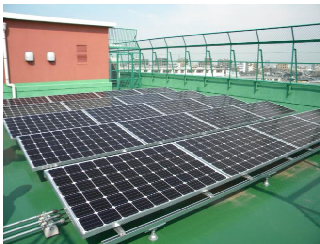
馬橋小学校の太陽光発電機器
