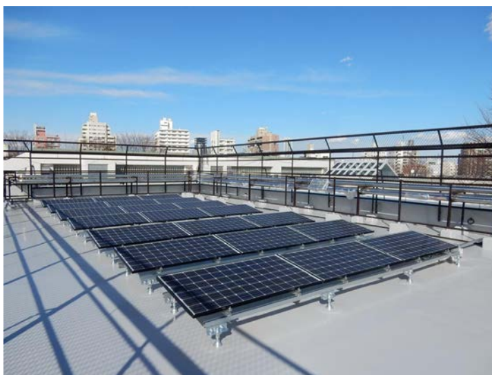
高南中学校の屋上に設置した太陽光発電パネル
