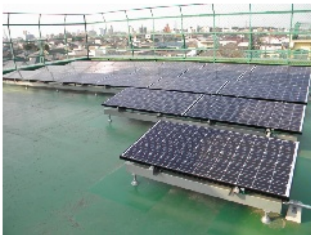
永福小学校の屋上に設置した太陽光発電パネル
