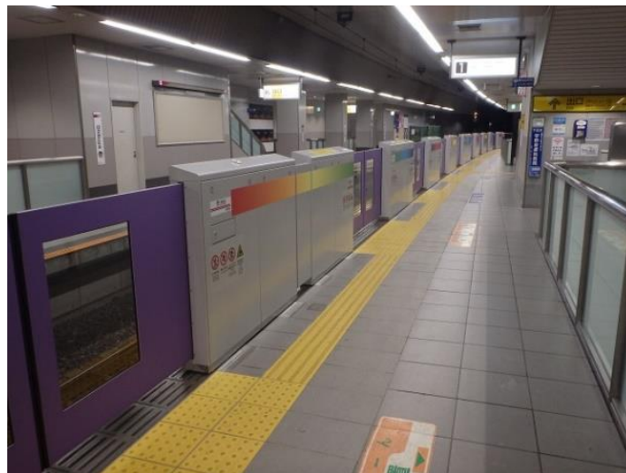
京王井の頭線渋谷駅のホームドア設置例
