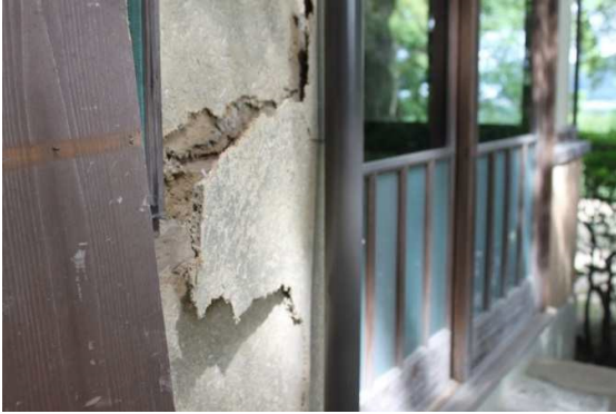
写真11 2018年6月18日大阪北部地震による被害
