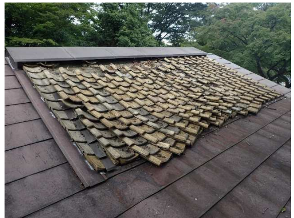
写真12 2018年9月4日台風21号による被害
