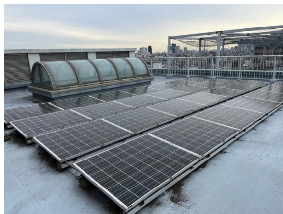
太陽光発電パネル（本庁舎屋上）
