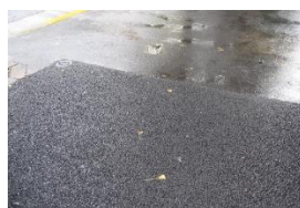
雨水を路面下に浸透させる透水性舗装
