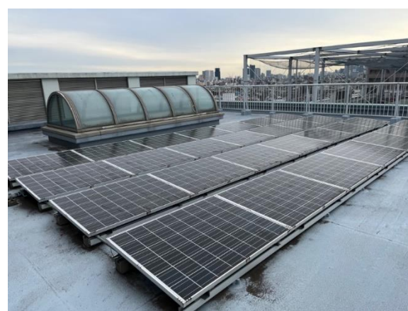
太陽光発電パネル（本庁舎屋上）
