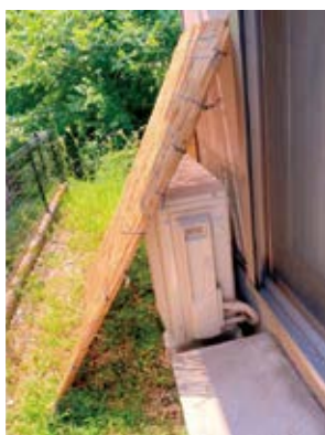
エアコン室外機を直射日光から守る 周りは風通しよく「よしず」に散水すると さらに効果的
