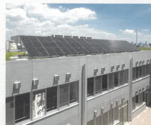
太陽光パネル
