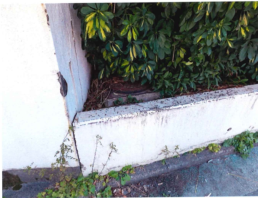
⑪屋外排水経路流末柵(埋設)
