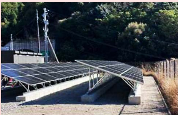
道路脇への太陽光発電施設の設置
