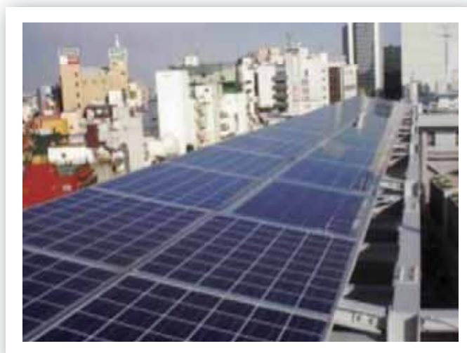
すぎなみ環境情報館に設置された太陽光発電パネル
